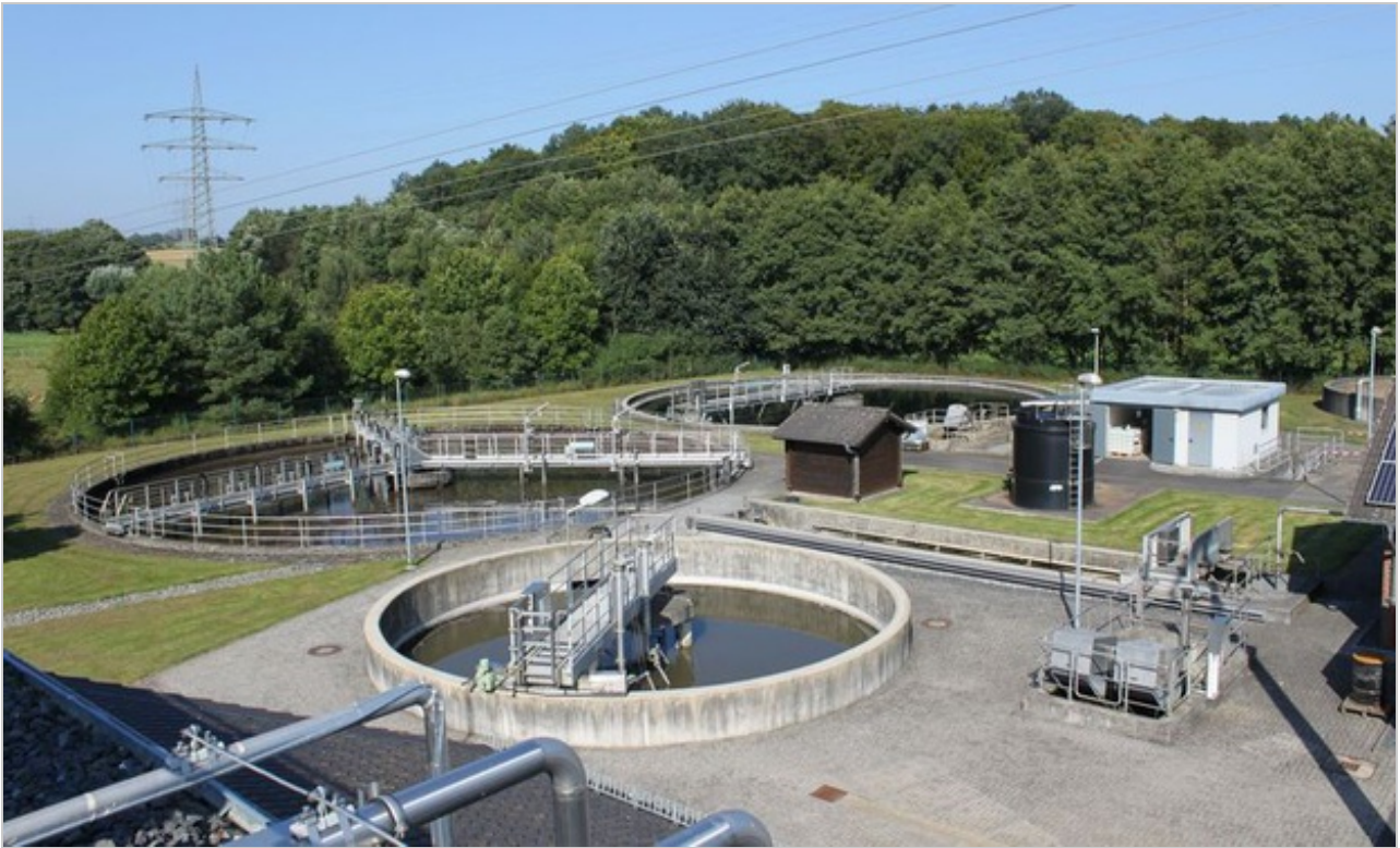
Kläranlage Selters. Foto: Heike Miehe, ZGV
