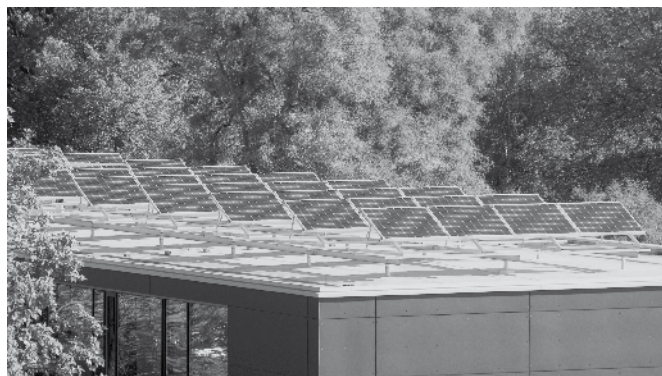
Fotovoltaikanlage auf dem Dach des Zentrums Gesellschaftliche Verantwortung
